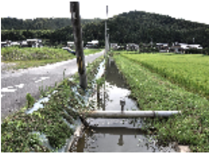
St①-1. 気山芋集落排水路:幅1.5mの アーム柵排水路。上流域は幅60cmの アーム柵排水路。川底は泥が堆積。満 潮時に冠水の危険がある。
